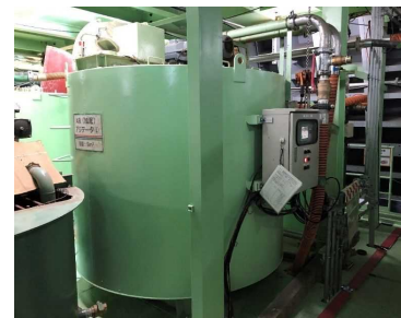
鉍物系添加材用泥水タンク
