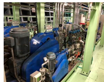
添加材注入ポンプ
