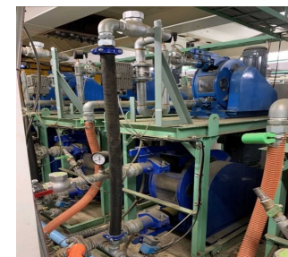
添加材注入ポンプ
