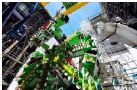
シールド機カッター部の投入・組立を行っている状況 (平成30年4月27日)
