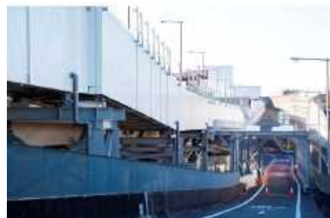
外環道のベルトコンベアの設置が完了した状況 (令和元年5月14日)
